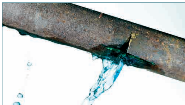
4.7.1. A csövek falának rozsdásodása és elvékonyodása csőtöréshez vezethet
